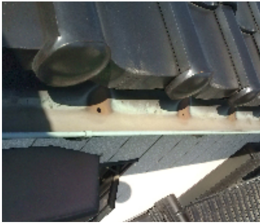
屋根から見ると、ぼつりぼつりと樋に穴が
