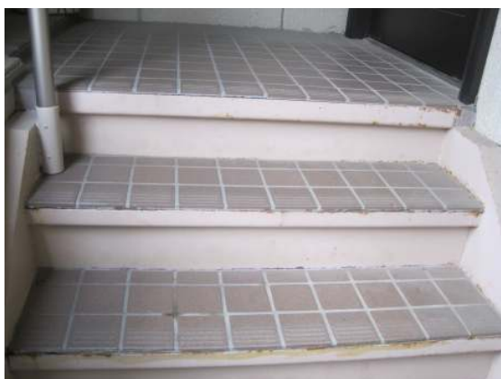
タイルは防水ではないので、鉄部が錆びてきます。
