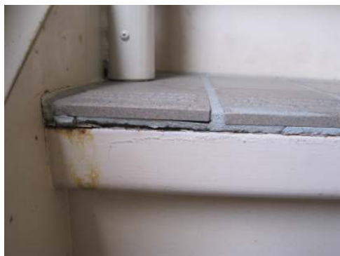
改修前の錆びた状態です
