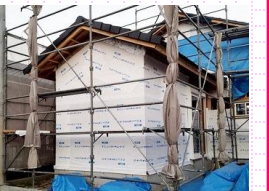
現在の現場の様子。外壁下地(防水シートや断熱材)を貼る工事を行っているところです。
