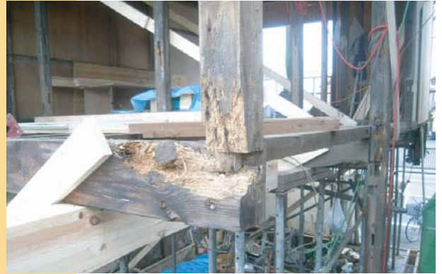
柱・梁の腐食
